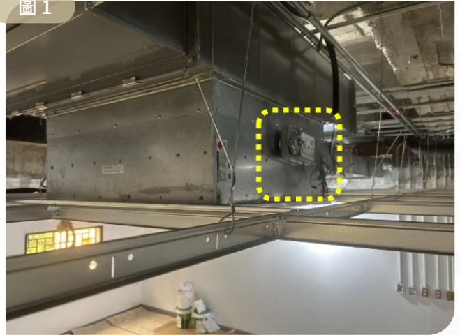
圖 1. 排煙閉門及葉片制動器(虛線圈選處)與風管銜接處接合樣貌(由陽鼎實業股份有限公司專業提供)
