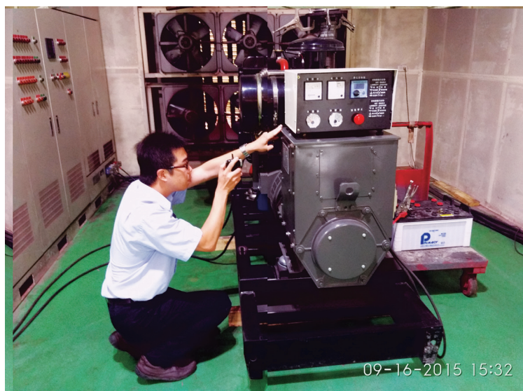
■緊急發電機—性能檢驗。
